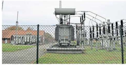
Zentral für das Wedemarker Stromnetz: Auch das Umspannwerk Meitze bei der Modernisierung umgerüstet und erweitert. FOTO: URSULA KALLENBACH
